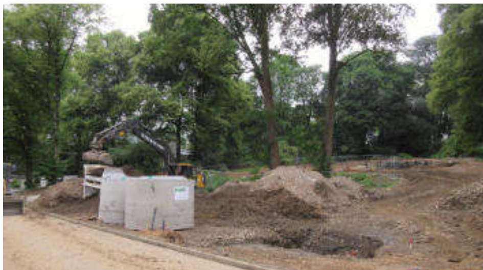
Die Wasserbehälter sind in Aralandia verbaut
